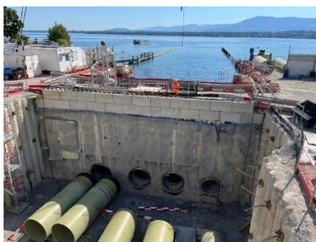
Figure 30 : Station de pompage du Vengeron, GeniLac®
